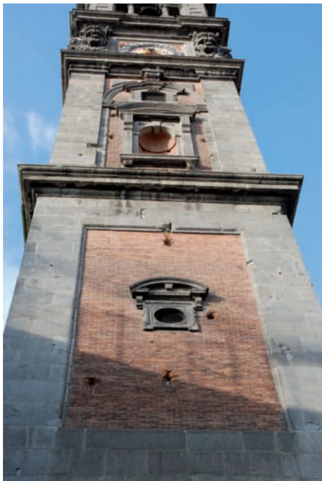
Varese, Campanile della Basilica di San Vittore con i segni delle cannonate degli austriaci del maggio 1859. Foto Studio Soldano Varese
